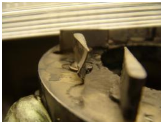
Aubes de tuyère endommagées.
